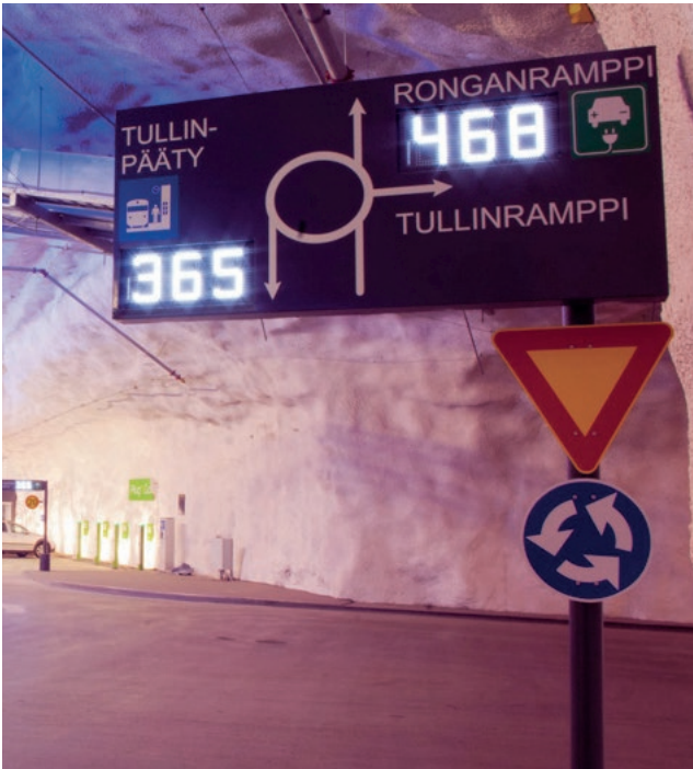
Kuva L1.5. Muuttuva pysäköintipaste Tampereen P-Hämpissä. (kuva: www.finnpark.fi )
